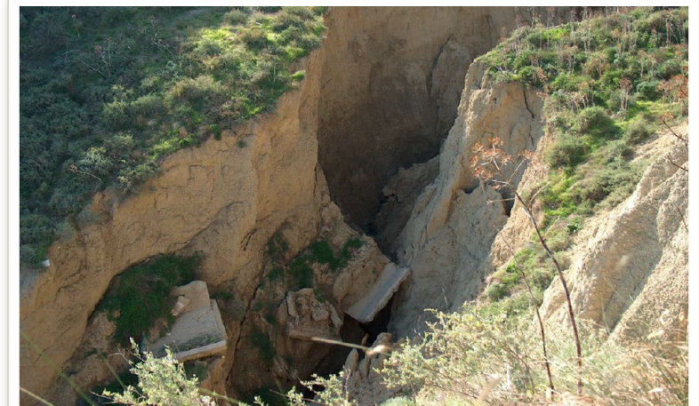
Blocchi in cls collassati nel Fosso Fornace
