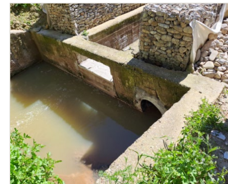
Vasca in cls di recapito della condotta fognaria (Punto A)
