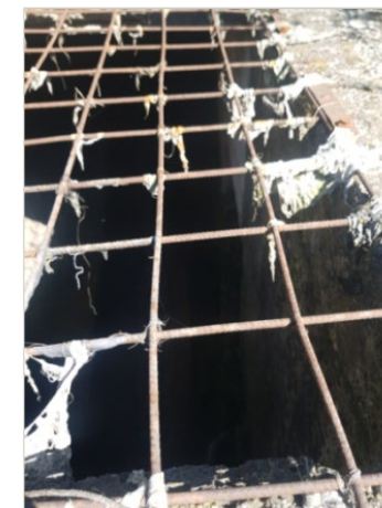
Griglia del pozzetto dello scatolare fognario con resti di rifiuti
