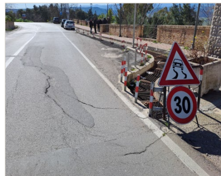
Lesioni e cedimenti nella sede stradale di Via Vespucci
