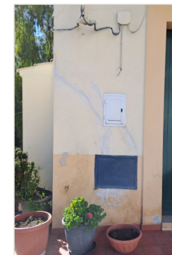
Lesioni in un fabbricato lungo Via Vespucci
