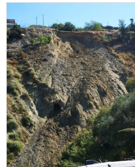
Nicchia di distacco della frana in località Macello (versante NW)
