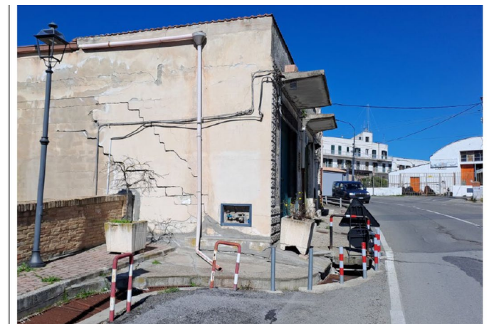
Fabbricato lesionato e cedimenti in Via Vespucci
