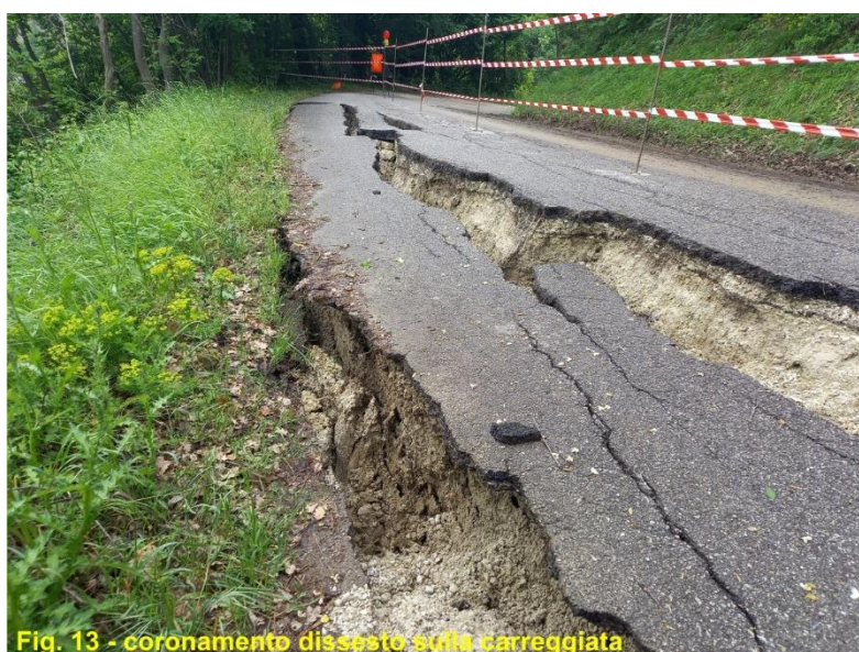
Fig. 12 - dissesto lato valle carreggiata
