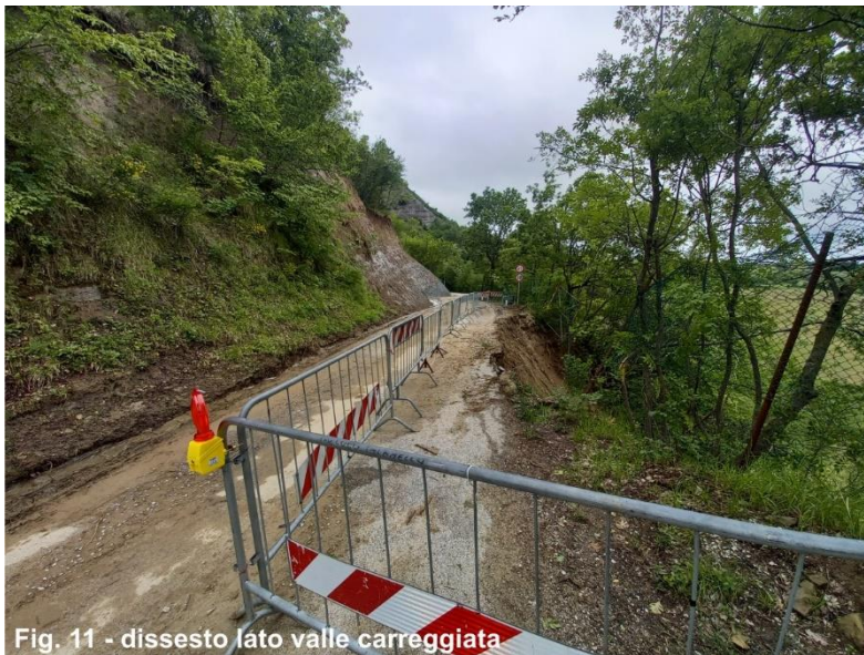
Fig. 10 - disesto lungo la scarpata progredito sulla carreggiata
