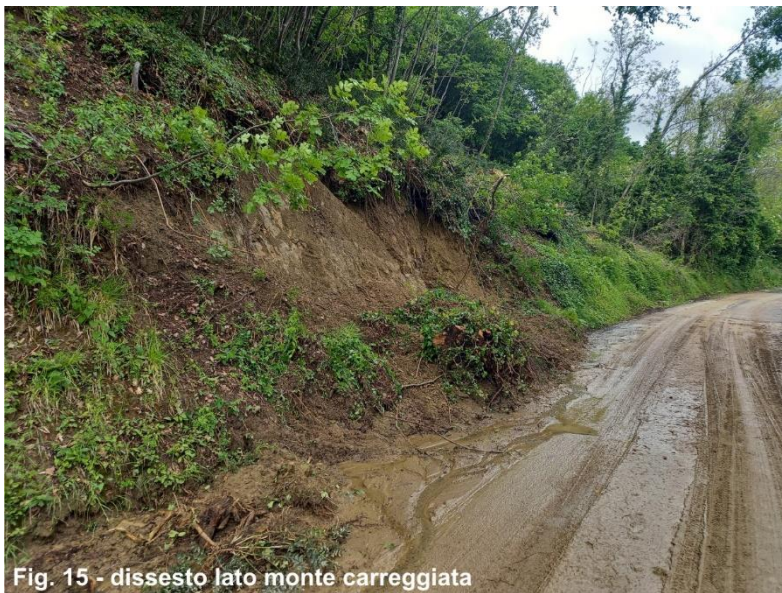
Fig. 14 - dissesto lato monte carreggiata
