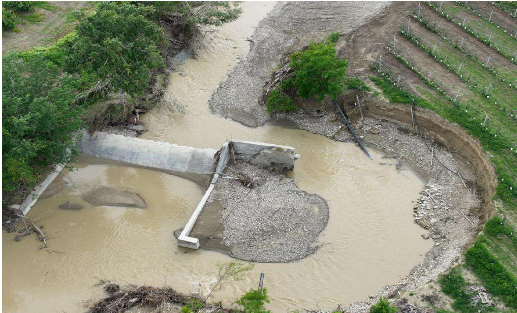
Erosioni spondali lungo gli argini del torrente Marzeno in loc. Marzeno (comune di Faenza)
