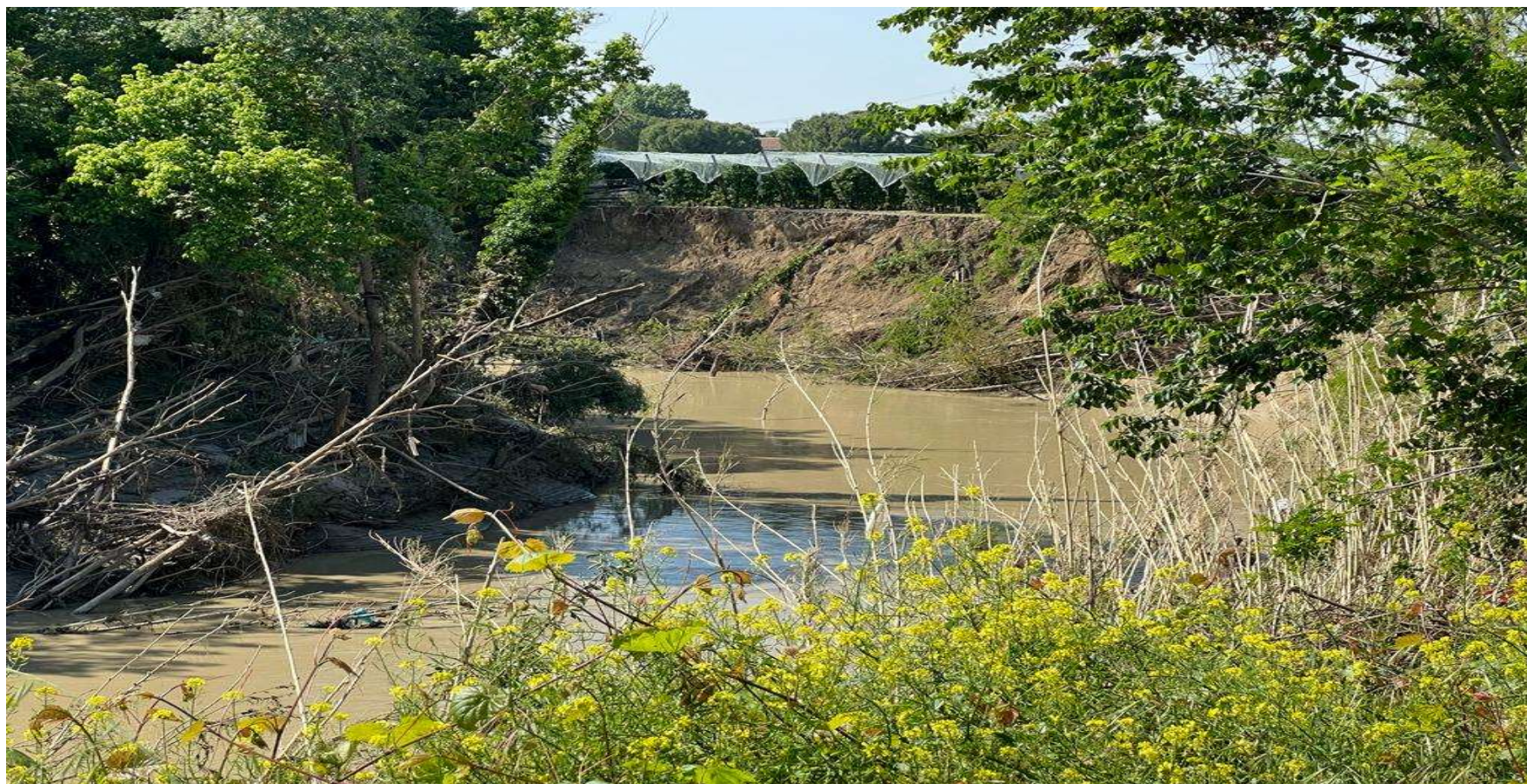
Erosioni spondali lungo gli argini del fiume Savio in loc. Matellica (Ravenna)
