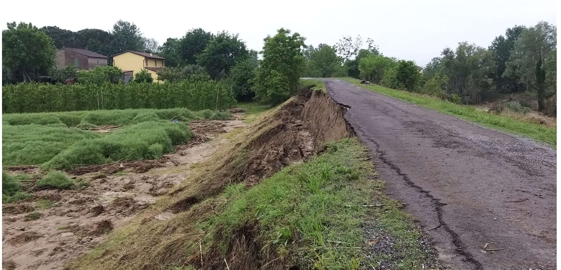
Erosione spondale degli argini del Lamone
