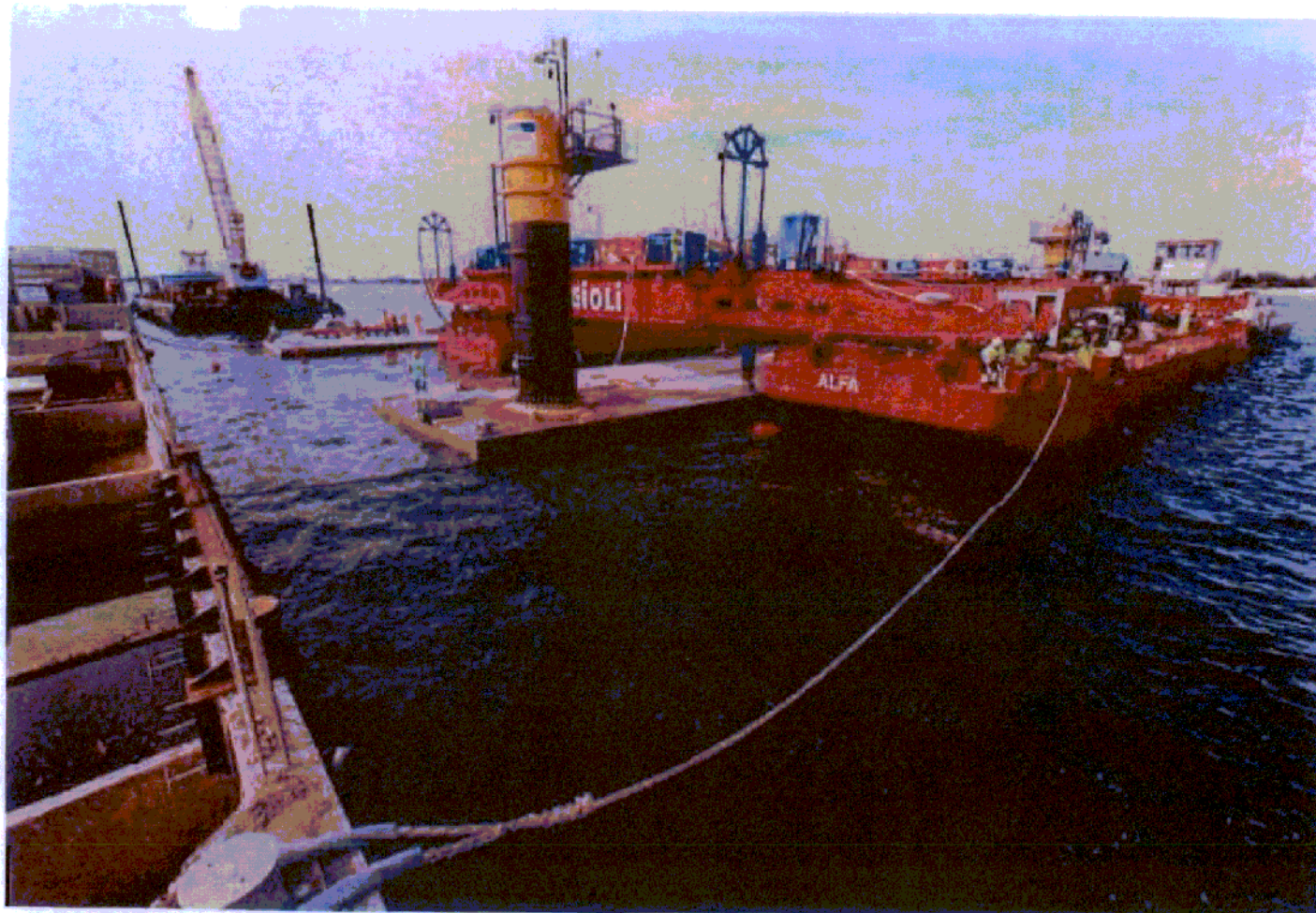
Bocca di Lido – Treporti: particolare delle attività di varo del primo cassone di soglia. Al 30/09/12, tutti i cassoni di Treporti sono stati varati e posizionati all'interno della relativa trincea
