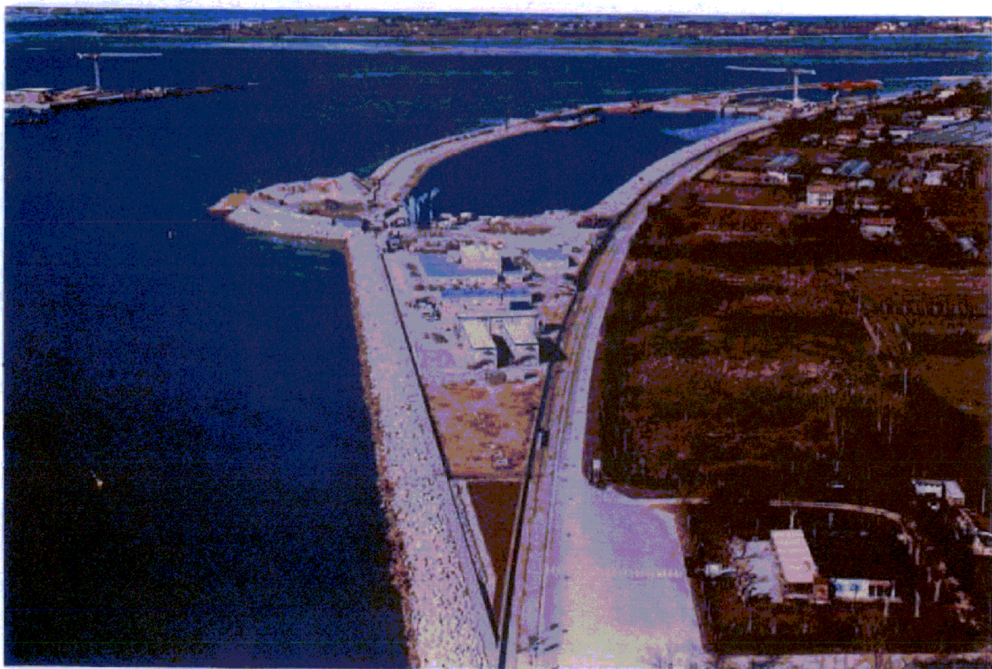
Bocca di Lido: veduta d'insieme delle opere a Treporti dopo il completamento delle attività di varo e posizionamento dei cassoni all'interno della trincea
