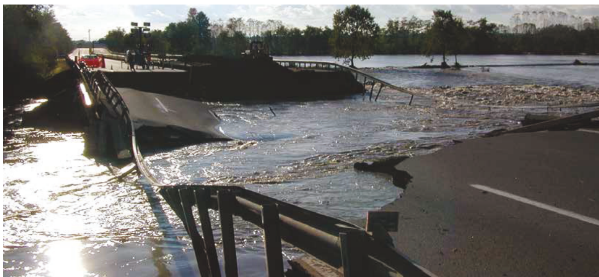
Foto 8.11 Crollo del viadotto dell'autostrada Milano - Torino sulla Dora Baltea - ottobre 2000 Fonte Archivio ISPRA Eutizio Vittori
