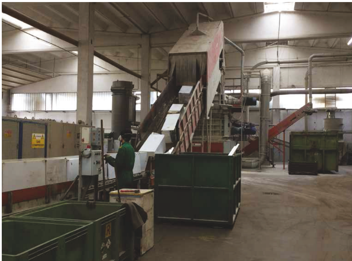
Foto 5.08 Impianto di riciclaggio Fonte MATTM
