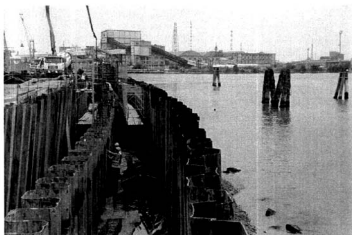
Canale Industriale Ovest sponda est: palancolato strutturale infisso all'interno delle ture provvisionali
