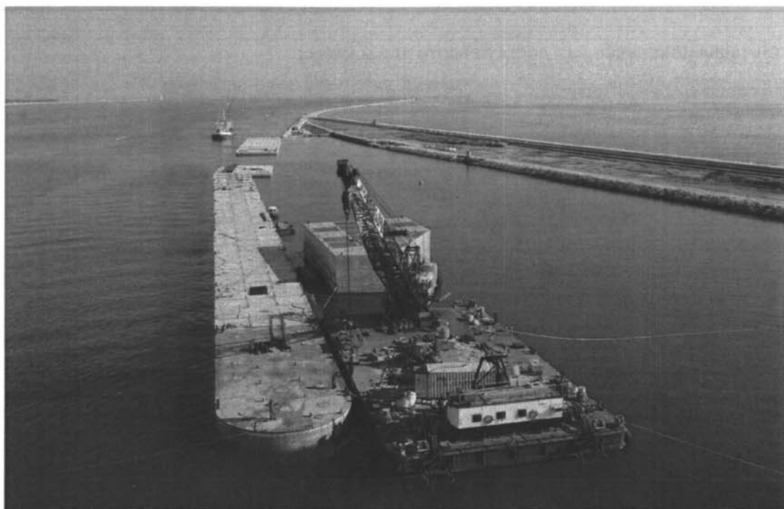
Bocca di Lido - S. Nicolò: i cassoni prefabbricati in calcestruzzo armato che costituiscono la struttura della spalla sud della barriera di S. Nicolò, già posizionati e zavorrati.
