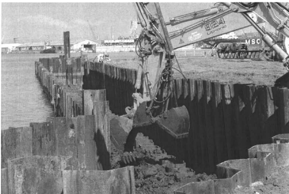
Fase di realizzazione delle opere di scavo preliminari alla realizzazione del cordolo sommitale, sul palancolato strutturale, all'interno delle tute provvisori
