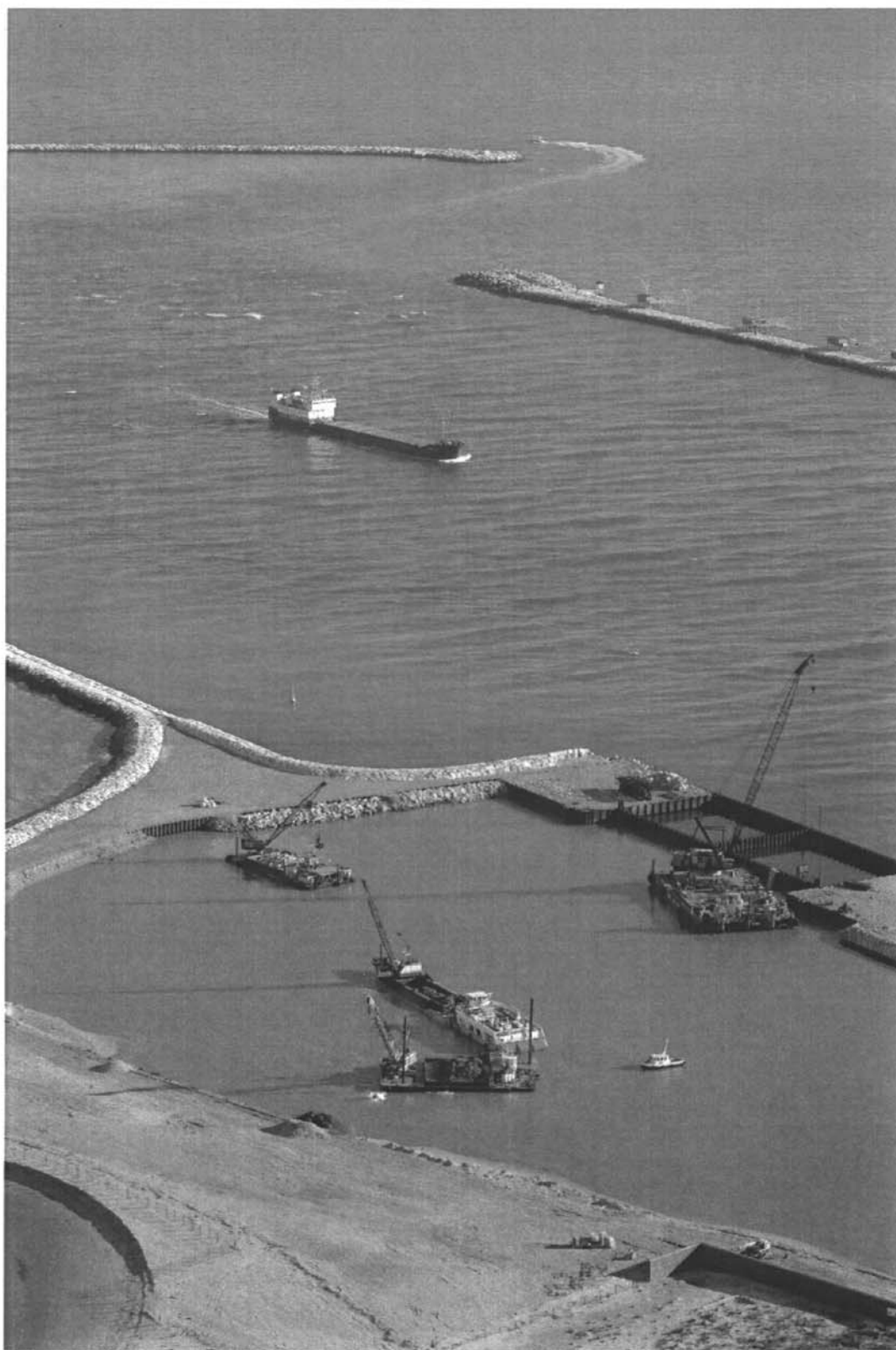
Bocca di Chloggia : porto rifugio lato mare, mezzi al lavoro per il dragaggio del bacino e l'infissione delle palancole per la realizzazione del bacino in vista della sua messa all'asciutto.
