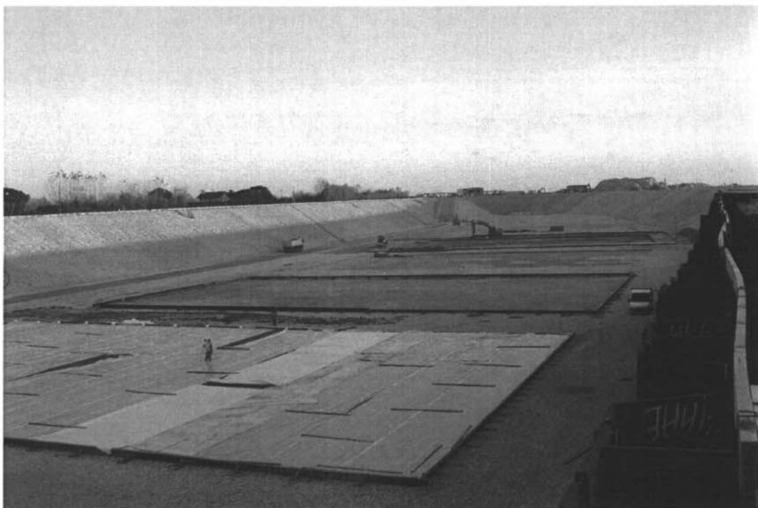
Bocca di Lido - Treporti : particolare del bacino del porto rifugio lato mare messo all'asciutto, con in primo piano la costruzione delle piastre di appoggio per la prefabbricazione dei cassoni.
