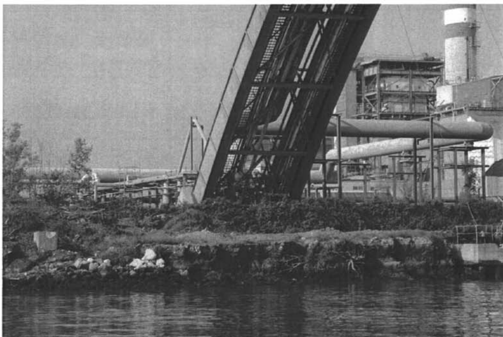
Canale industriale sud sponda sud, area Syndial – Polimeri Europa. Stato di fatto di un tratto di marginamento
