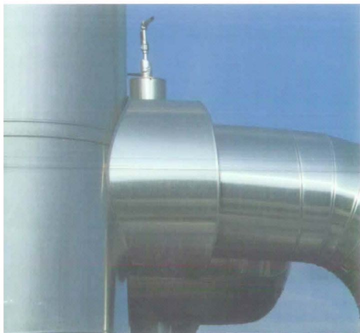
Bagnore (Grosseto) • Centrale geotermica del Monte Amiata
