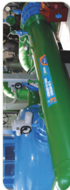
Vista interna della centrale di Villa Castelli
