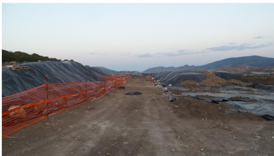
Immagini dei cumuli di terra inquinata e dei movimenti terra che hanno devastato il sito protetto del Poligono di Capo Frasca
